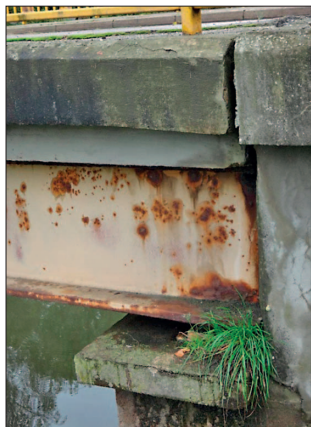
Une photo prise avant les travaux: le pont commençait à montrer de sérieux signes d'usure.
